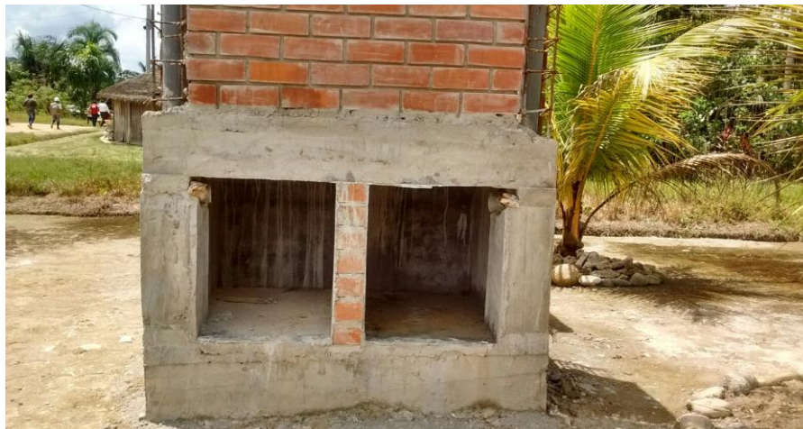
Vista de las cámaras composteras
